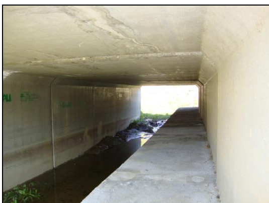
Obra de drenatge adaptada pel pas de fauna
