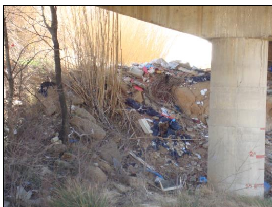
Abocament de deixalles sota el viaducte de la N-II
